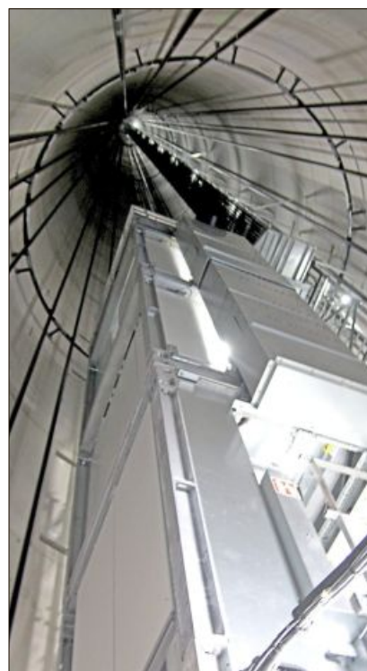
Bei Wartungsarbeiten muss man innen an der Anlage hinaufsteigen.
