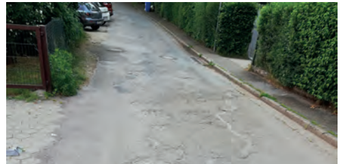
Beschädigungen der Straße „Am Dandelberg“
