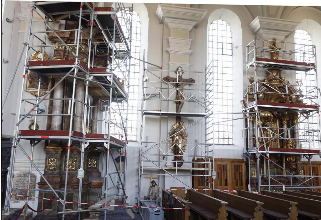
Für 140 000 Euro musste die Wartemberger Pfarrkirche nach einem Vandalismusschaden einer „überbrückenden Pflegemaßnahme“ unterzogen werden. © Klaus Kuhn
