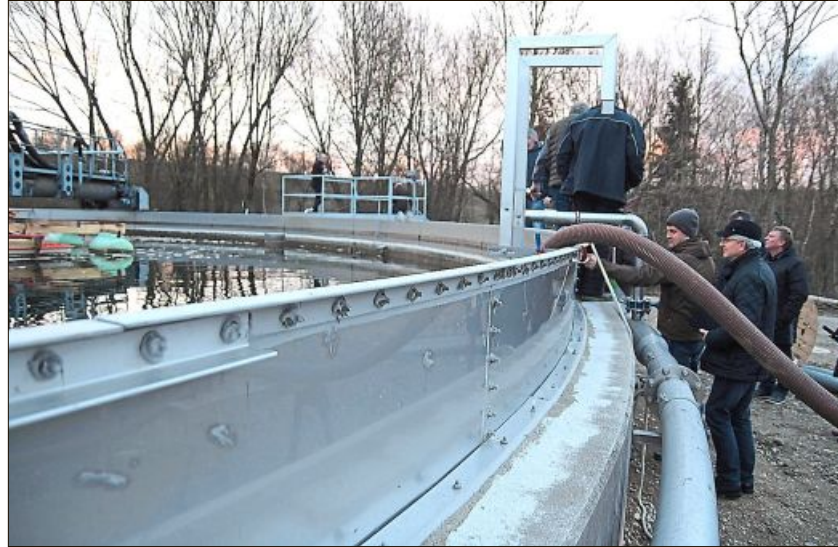
Die Kosten für die Erweiterung der Kläranlage, hier das erhöhte Belebungsbecken, sind jetzt auf die Gebühren umzulegen.
